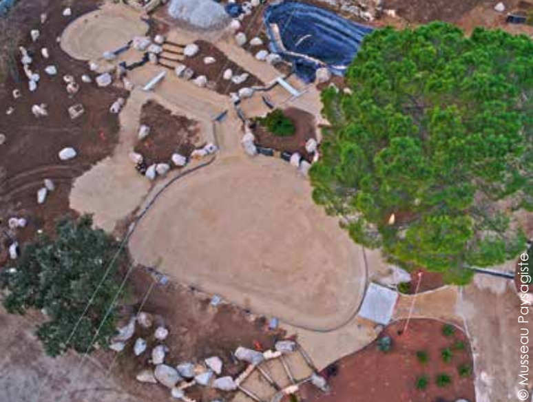
Ce chantier, réalisé par Musseau Paysagiste, intègre trois bassins et deux rivières. L'étanchéité est assurée par un Bidim feutré en tissu de 450 gr/m 2 puis une membrane EPDM de 1 mm d'épaisseur.
